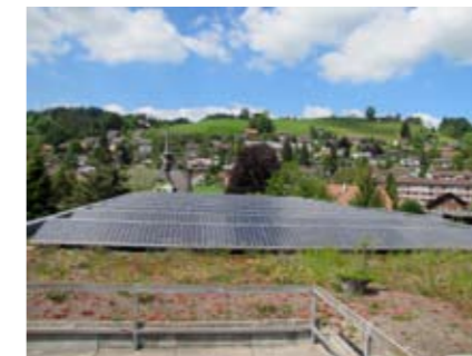
Photovoltaikanlage auf dem Dach der Sekundarschule Langnau
